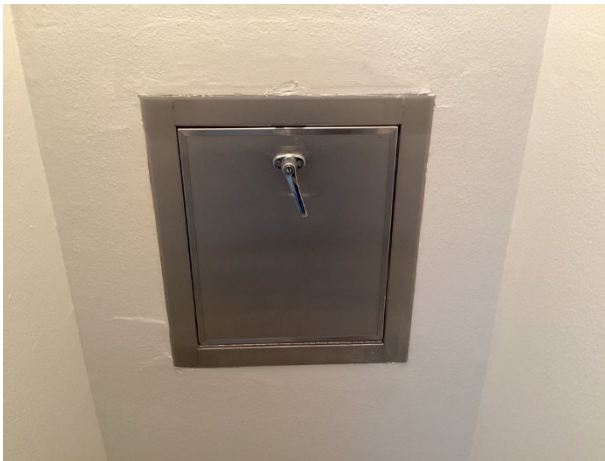
Trash chute door
